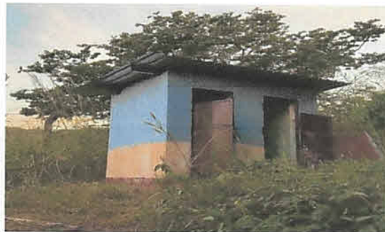
Foto 2: Servicios sanitarios colapsados
